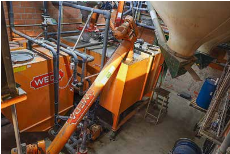
Die Flüssigfütterungsanlage wird in regelmäßigen Abständen gereinigt und gewartet. So sieht man ihr das Alter von fast 30 Jahren kaum an.
